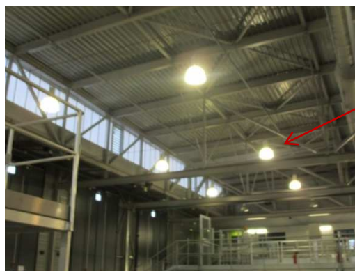
Canalis pour l'éclairage du hall
