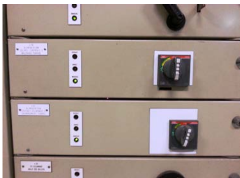
Façade TGBT ancienne génération
