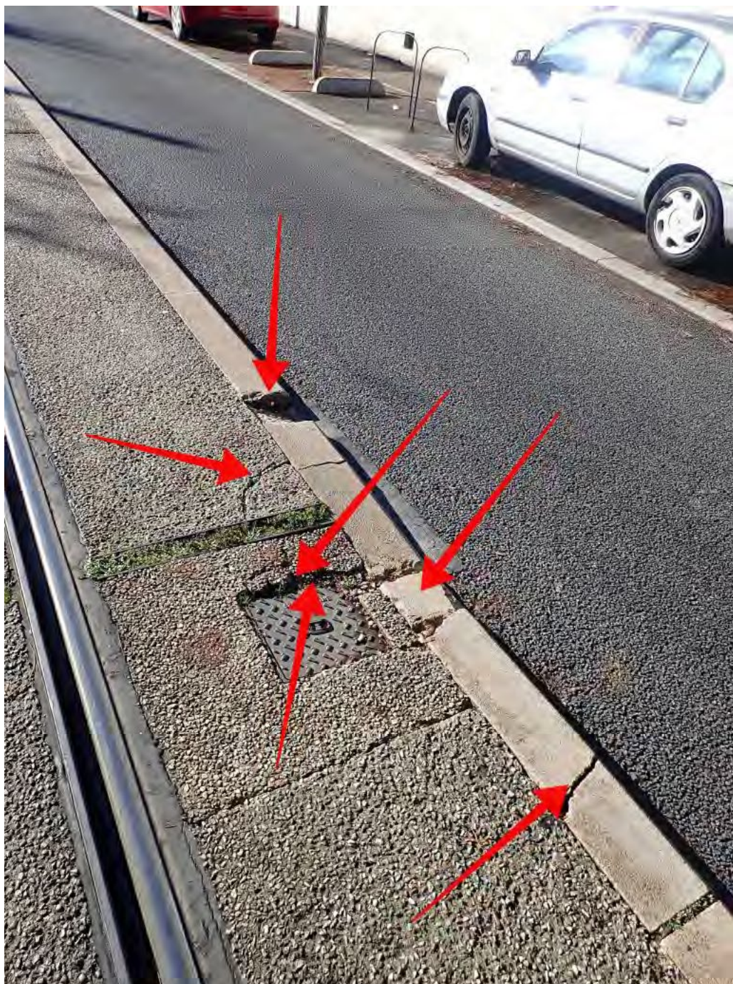
Avenue de Muret Bordures cassée, enfoncée, ébréchée et affaissement d'un regard.
