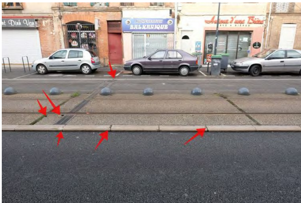
Avenue de Muret Fissuration du béton désactivé clair. Bordure GLO ébréchée Caniveau enfoncé 17 décembre 2018
