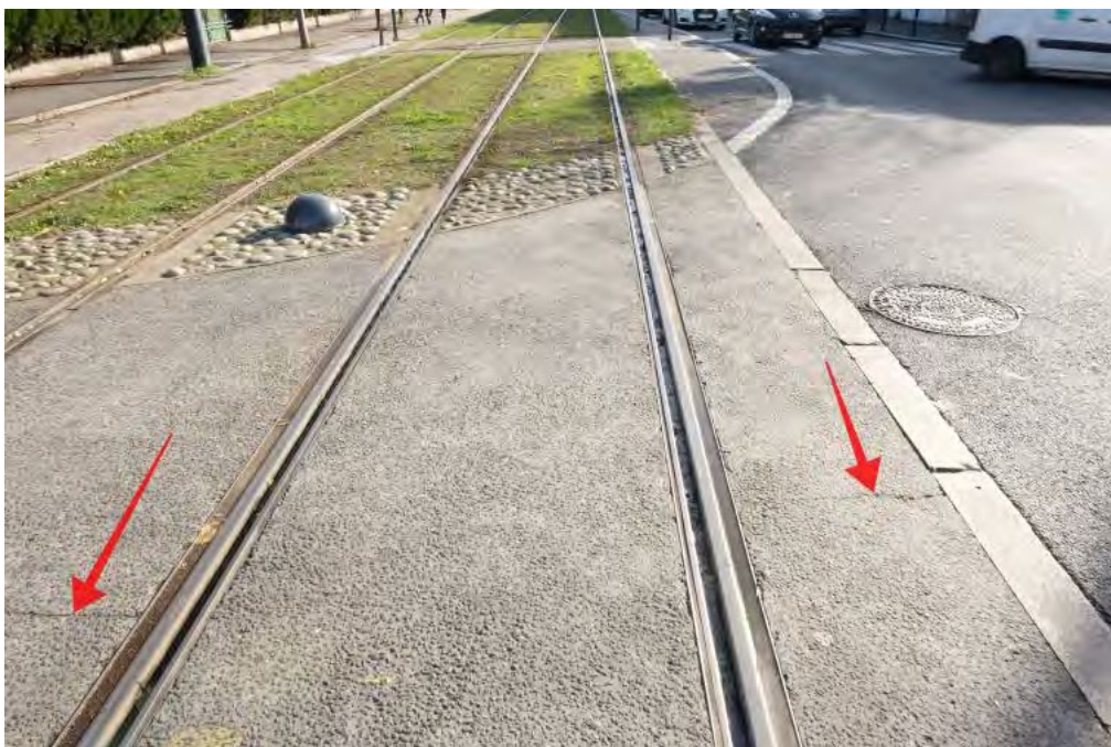
Carrefour rue Déodat de Séverac-rue Nungesser et Coli. Fissuration du béton désactivé noir
