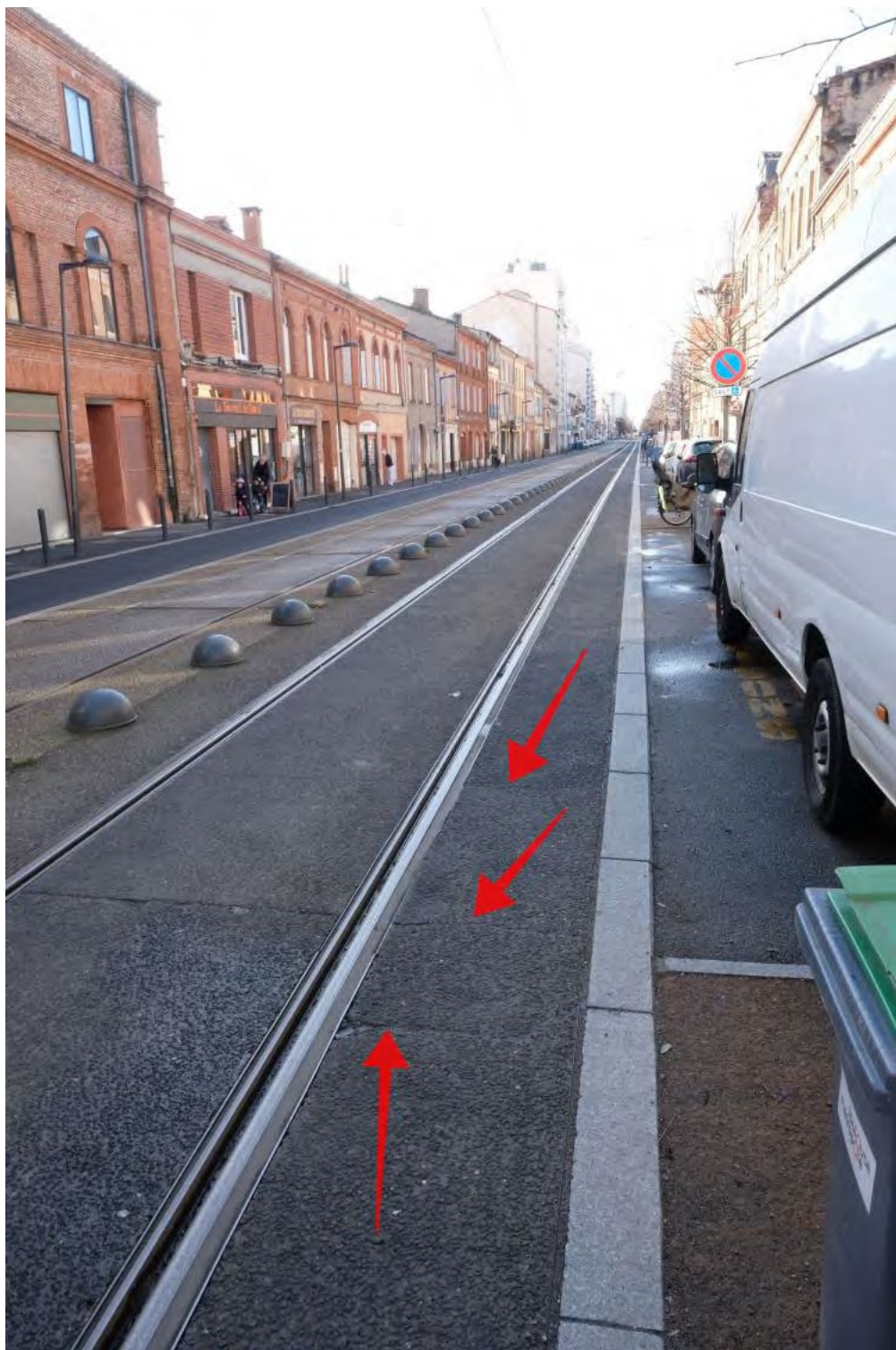
Avenue de Muret Fissuration du béton désactivé sombre.
