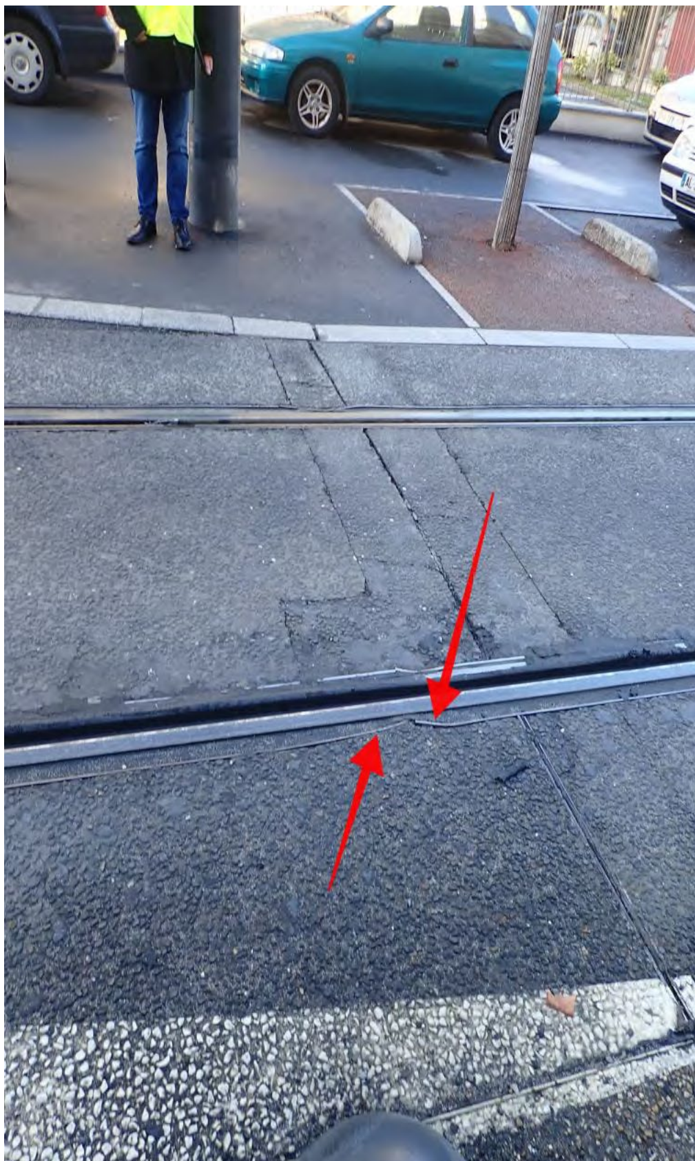
Avenue de Muret Un peu au Nord de la station Marcel Cavaillé. 2 fers plats désalignés. 19 décembre 2017.
