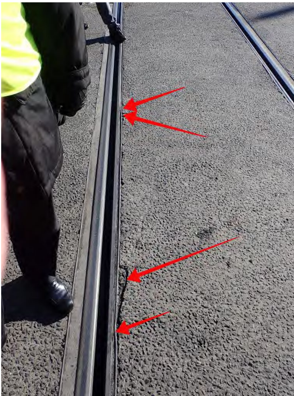
Carrefour rue Déodat de Séverac-rue Nungesser et Coli. Une fissure entre les deux voies au passage des rues. Un peu de dégradation, un fer plat tordu et repris. 19 décembre 2017.
