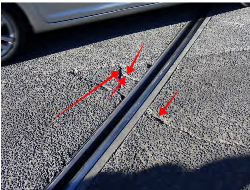
Virage Koenig Fissuration du béton désactivé noir, plaques descellées.
