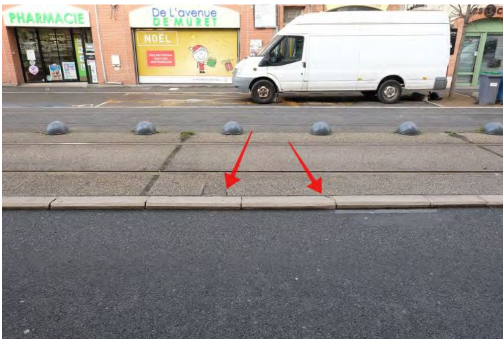
Avenue de Muret Fissuration du béton désactivé clair. Bordure GLO ébréchée.
