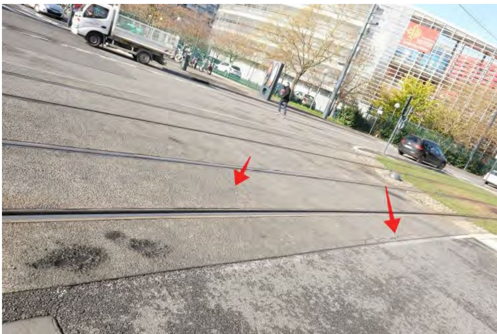
Carrefour rue Déodat de Séverac-allée Maurice Sarraut Fissuration du béton désactivé noir.
