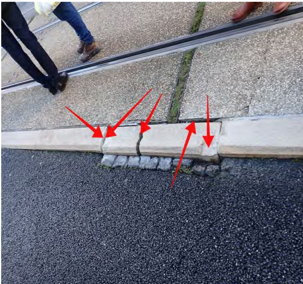
Avenue de Muret. Bordure GLO, Cassée, descellée. 19 décembre 2017.
