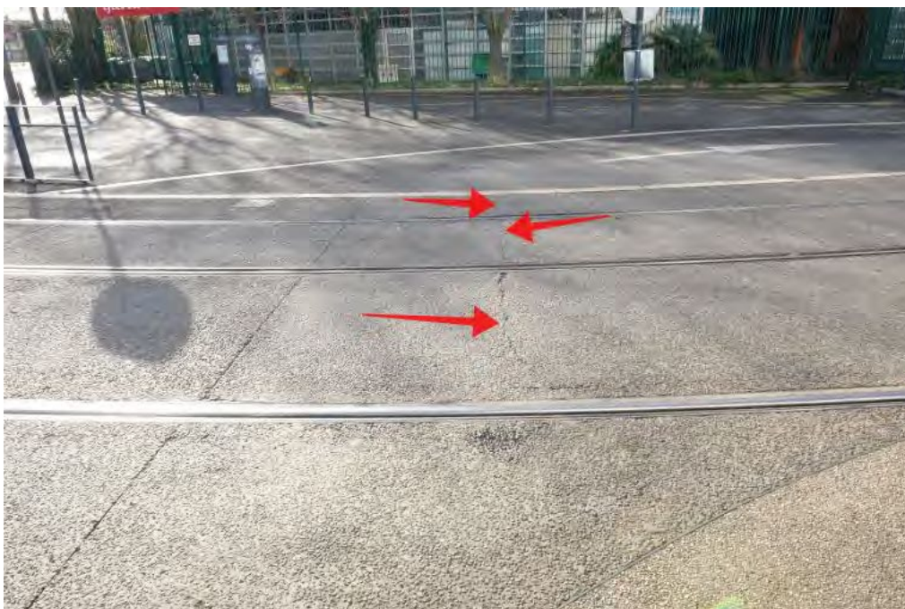
Arènes, entrée des bus Fissuration du béton désactivé noir.
