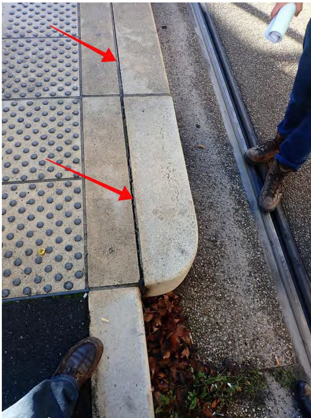
Avenue de Muret station Marcel Cavaillé Ouverture du joint de 3 bordures de plateforme. 19 décembre 2017.
