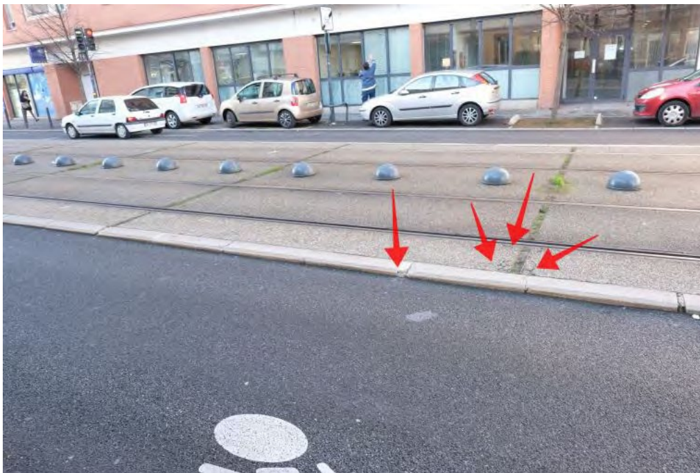
Avenue de Muret. Fissuration béton désactivé clair 17 décembre 2018.
