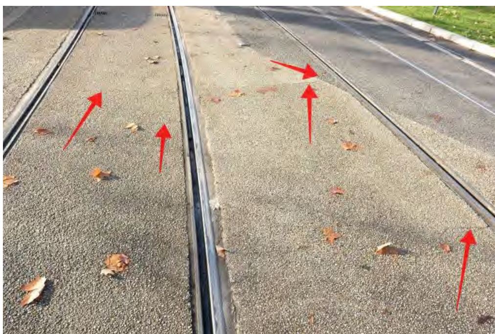
Avenue de Muret Fissuration du béton désactivé clair.
