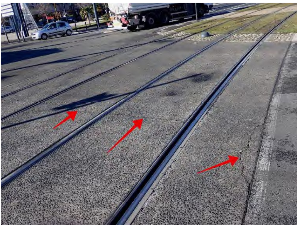
Carrefour rue Déodat de Séverac-rue de Cugnaux Deux fissures, une le long d'un fer plat latéral et une entre les deux voies. Les fers plats ont été réparés.
