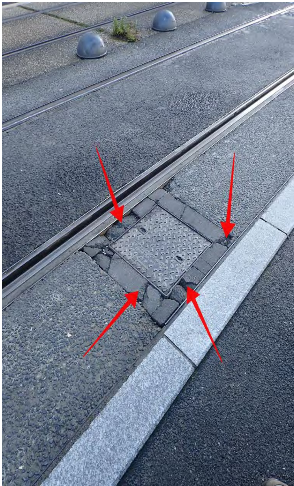
Avenue de Muret. Tampon déjà repris. Se dégrade à nouveau. 19 décembre 2017.
