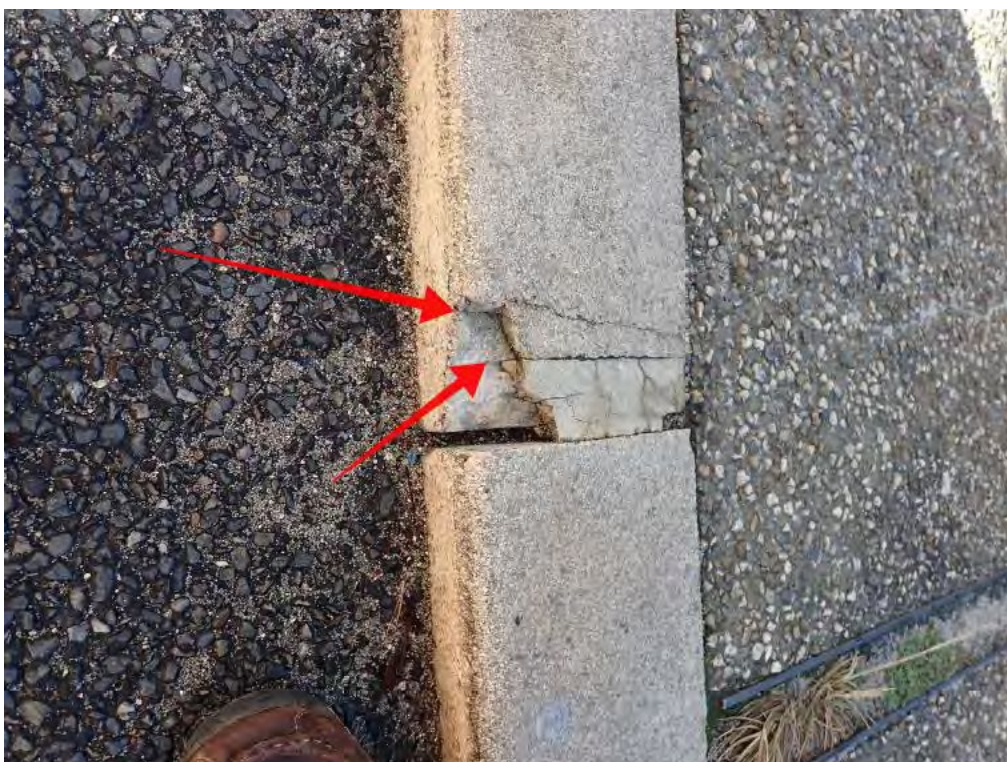
Avenue de Muret station Marcel Cavaillé Bordure GLO épaufrée, réparée.
