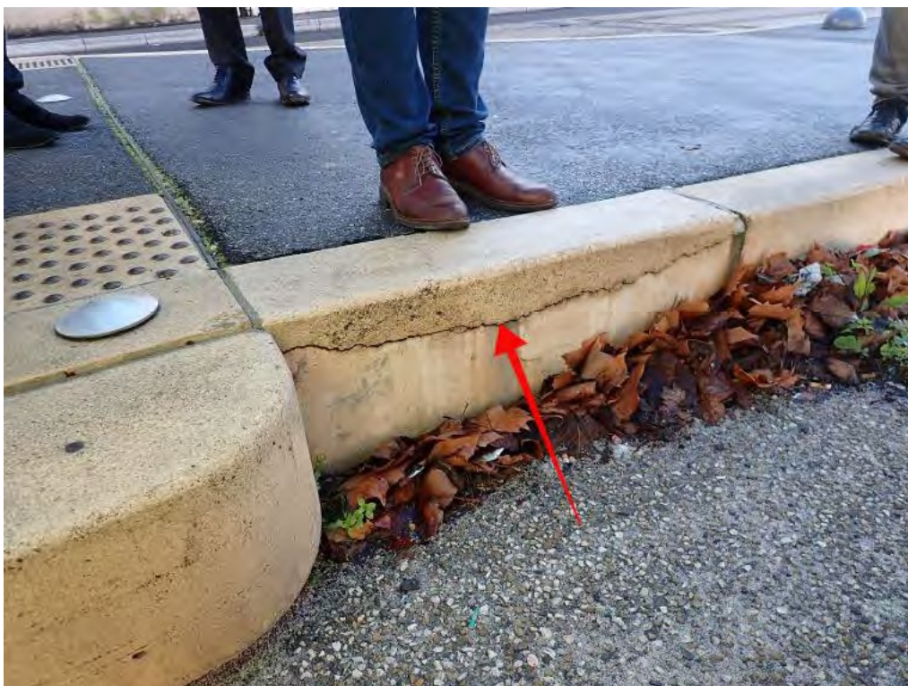
Avenue de Muret station Marcel Cavaillé Bordure cassée.
